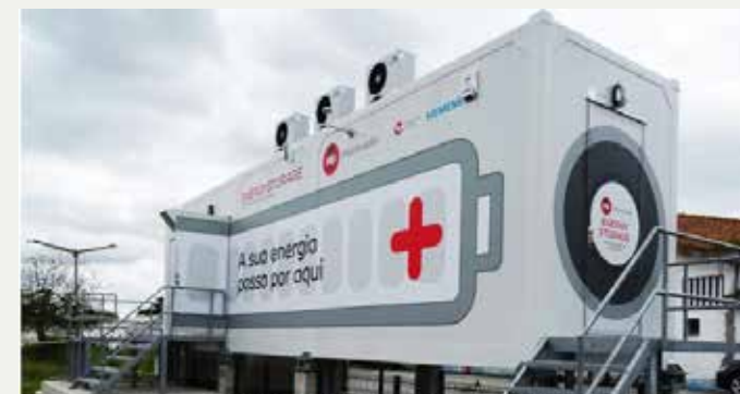
Figure 1 - EDP Distribuição Energy Storage System
